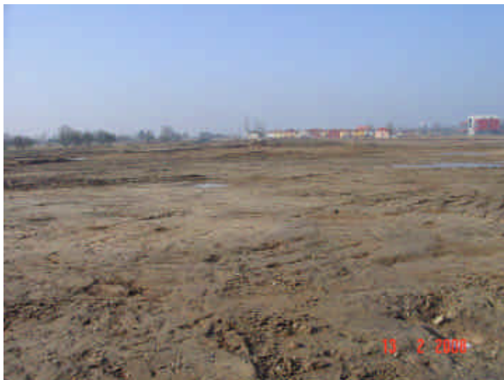
Bild 38: Sanierung F58 Ansicht von Westen Westteil der Fläche nach Fertigstellung der Sanierungsarbeiten
