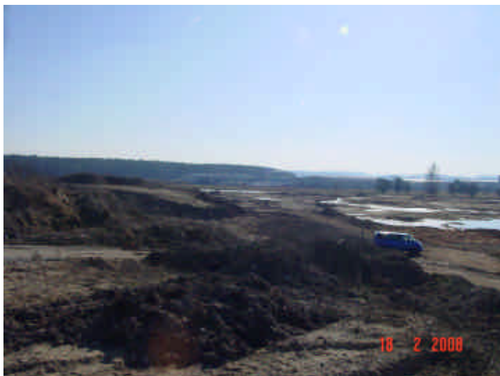
Bild 39: Sanierung F58 Ansicht von Norden Ostteil der Fläche nach Fertigstellung der Sanierungsarbeiten
