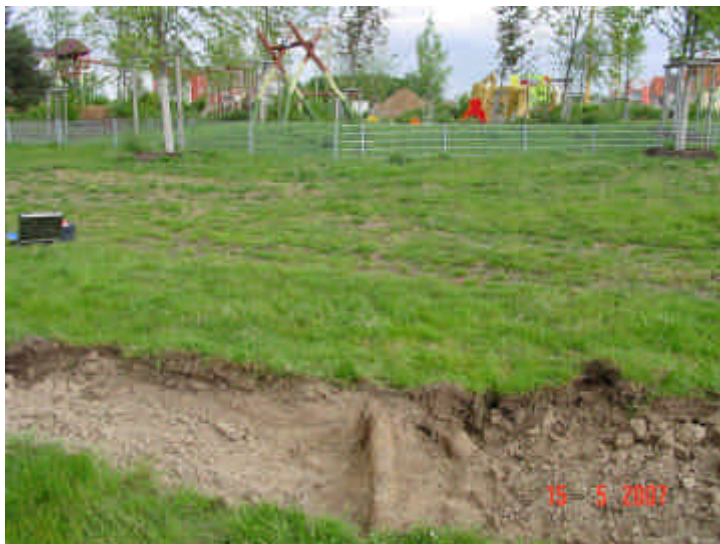
Bild 2: Schurfgrube S7 Ansicht von Süden Alte Leitung unterhalb der Grasnarbe Im Hintergrund Spielplatzflä- che
