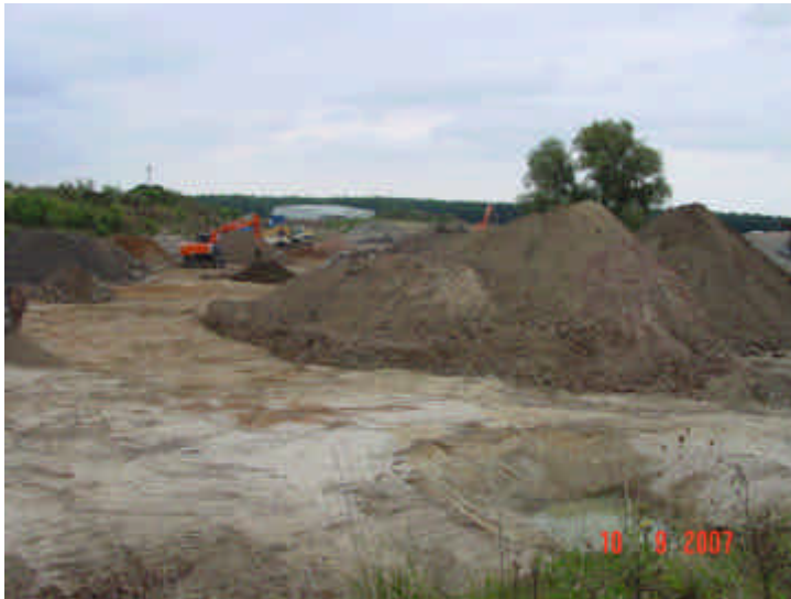
Bild 29: Sanierung F58, Bereich Nord Ansicht von Nord/West Haufwerke mit ausgekofferten und gesiebten Auffüllungen
