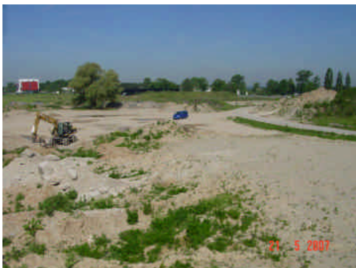
Bild 15: östliches adidas Gelände Standort auf einem Haufwerk Ansicht von Osten abgelagerte Haufwerke
