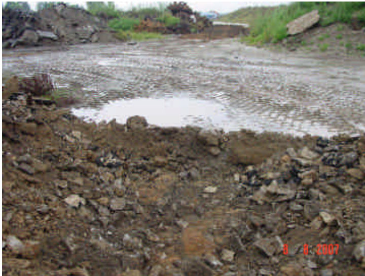
Bild 10: Sanierung F58, Nordteil Sanierungsfläche nach dem Abtragen der Überdeckungen: zerstörte PAK- haltige Schwarzdecke mit Schotterunterbau
