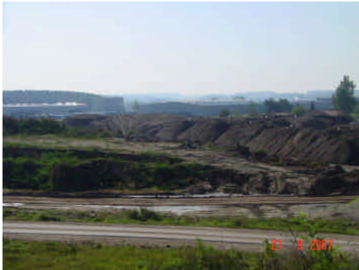
Bild 31: Sanierung F58 Ansicht von Norden Siebbereich, markierte und beprobte Haufwerke mit Feinabsiebungen
