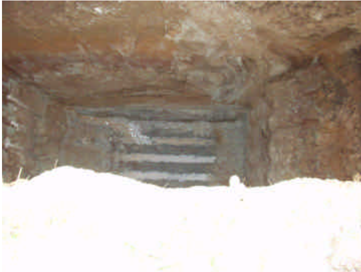
Bild 19: beginnender Wasserzutritt bei Schurf 3 (Untersuchungsphase: DU)
