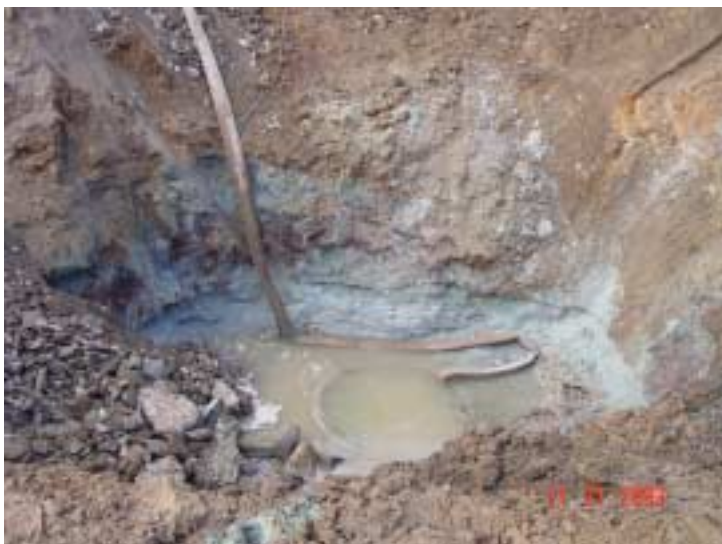
Bild 3: Wasserzutritt bei ca. 3,90 bis 4,00 m (Bereich zwischen den Schachtbauwerken HS-S01 und HS-S05)
