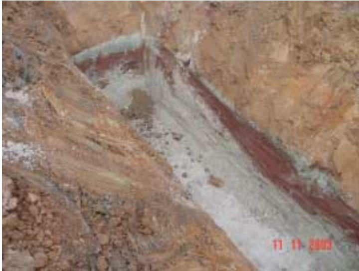
Bild 4: Typisches Bodenprofil: braune, marmorierte sandig-schluffige Materialien unterlagert von einer rotbraunen und blaugrauen schluffig - tonigen Sperrschicht; liegend folgen hell- bis blaugraue (mittelsandige) Feinsande
