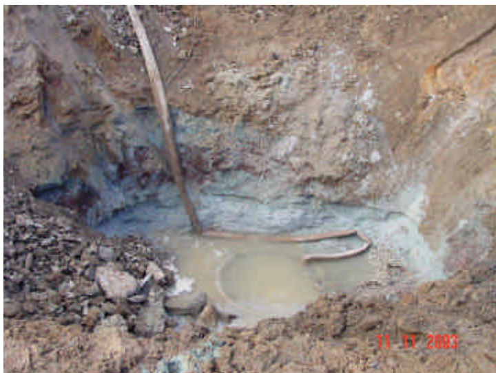
Bild 3: Wasserzutritt bei ca. 3,90 bis 4,00 m (Bereich zwischen den Schachtbauwerken HS-S01 und HS-S05), Wasserhaltung (Untersuchungsphase: Erstuntersuchungen Kanalbau)
