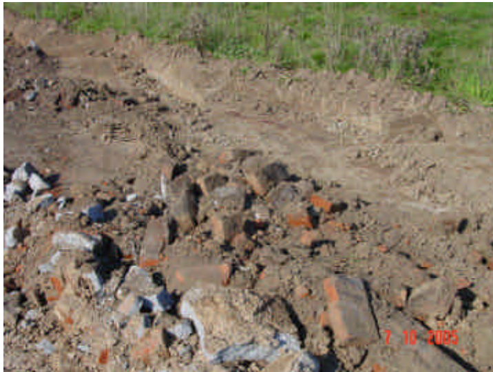
Bild 13: Sanierung Golfplatzgelände /Teilbereich Landebahn, 2005 Detailansicht zerstörter Landebahnaufbau – Ziegel mit Teerbelag vermischt mit Bodenmaterial
