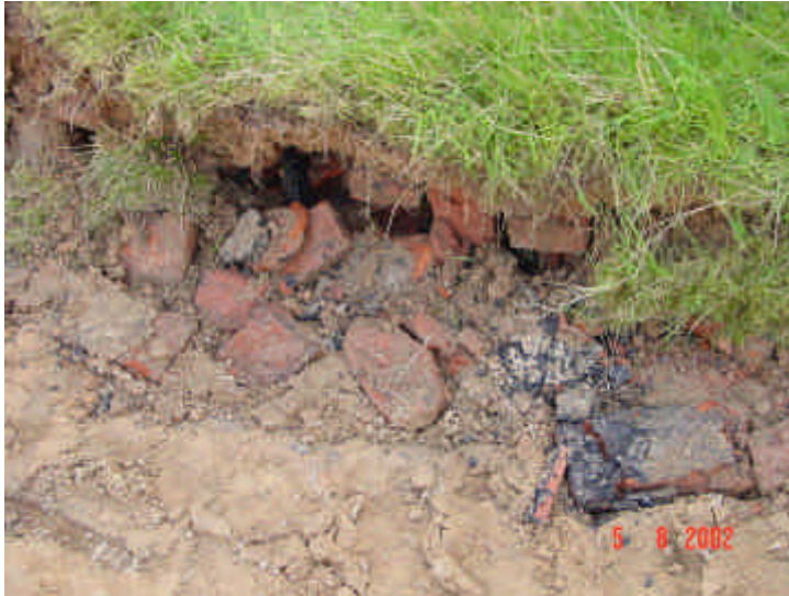
Bild 1: Altlastensanierung II, 2002/03 Landebahnaufbau Detailansicht Ziegel mit Teerbelag unter Überdeckung mit Erdreich
