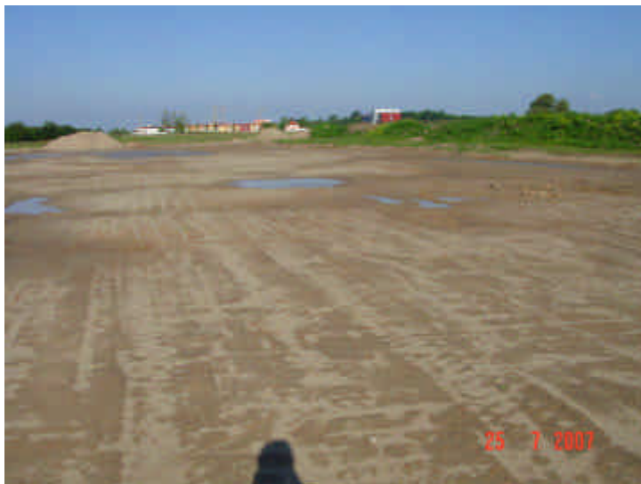
Bild 26: Sanierung Landebahn Ostteil F43, 2007 Sanierungsflächen nach dem Wiedereinbau von Bodenmaterial - Ansicht von Osten
