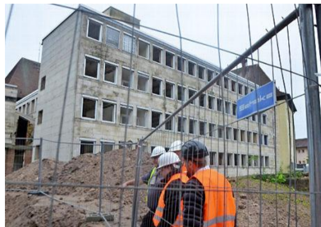
Noch steht das Rathaus, allerdings inzwischen völlig entkernt und ohne Fenster.
