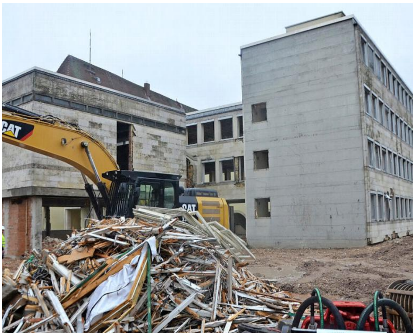
Das Rathaus aus den 60-er Jahren ist bereit für seinen endgültigen Abbruch.
