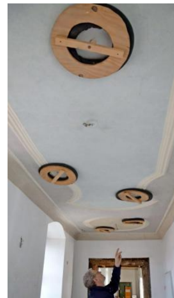
Bürgermeister German Hacker zeigt an einer Musterfläche, wie die Stuckdecken gesichert werden können.
