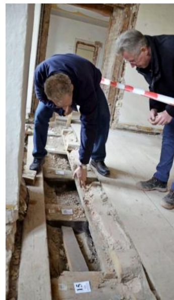
Projektleiter Jürgen Ziegler zeigt dem Bürgermeister einen Bodenestrich. Manches ist im Laufe der Jahrhunderte verändert worden.
