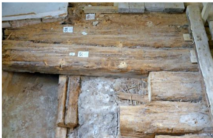
Eine Stelle mit besonders schadhafte Balken.
