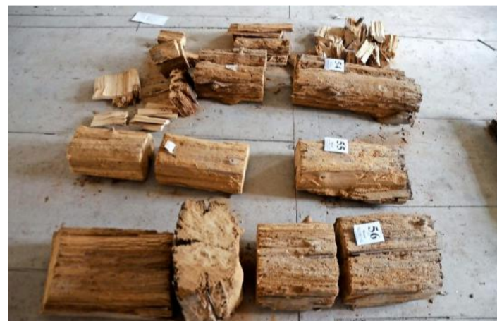
Die zerfressenen und vermoderten Teile wurden entfernt.
