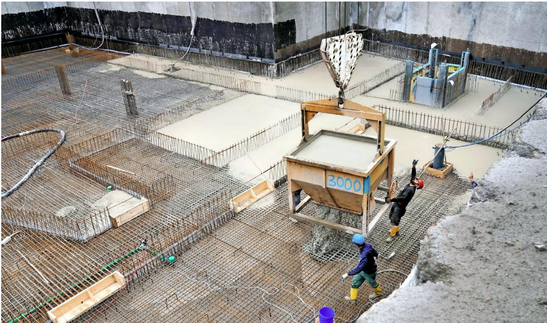
Die Großbaustelle Rathaus am Mittwoch: Die Bodenplatte wird betoniert. Unser Foto entstand zur Mittagsstunde
