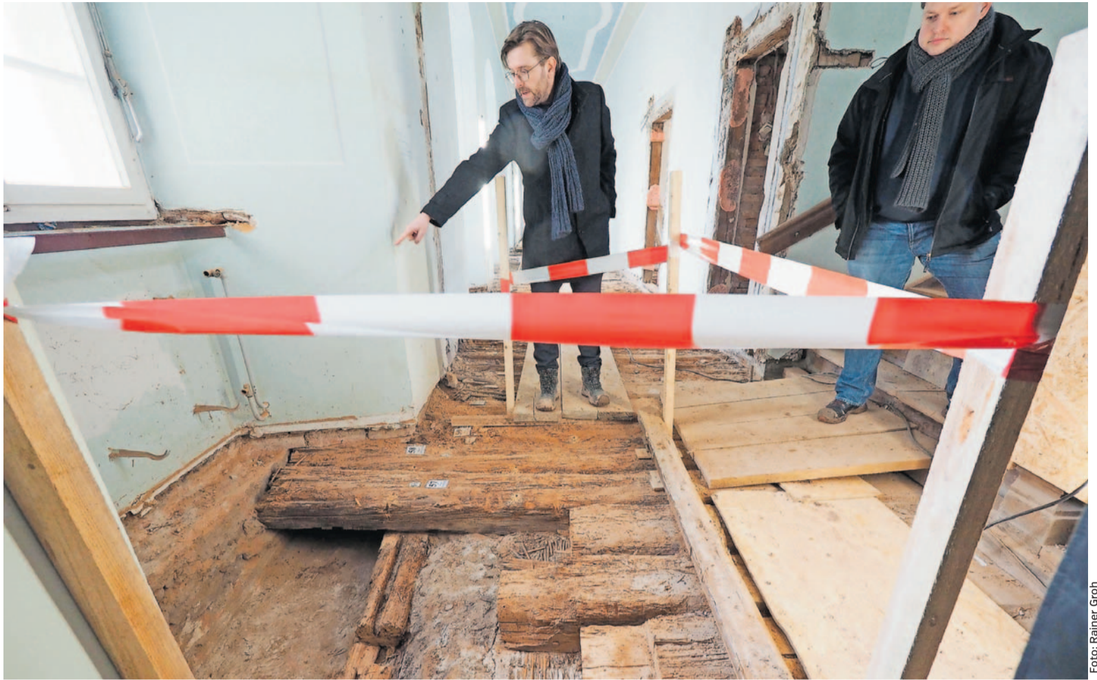
Im Ersten Stock des Ostflügels, zuletzt von der Stadtbücherei genutzt, fanden sich die schlimmsten Schäden. Architekt Christoph Schmidt zeigt auf die „Mann-an-Mann“-Konstruktion der Balkendecke, die unter Nässe und Insektenfraß so gelitten hat, dass Teile der Balken durch neue aus Eichenholz ersetzt werden müssen.
