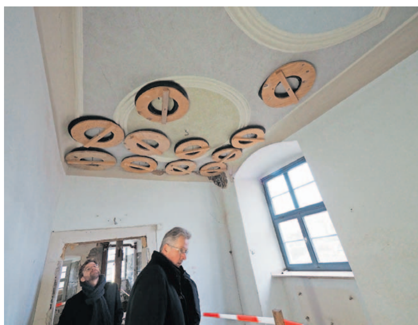
Mit Holzringen und Schläuchen von Schubkarrenrädern werden die Stuckdecken fixiert, darunter links Architekt Christoph Schmidt, rechts Baubegleiter Jürgen Ziegler.
